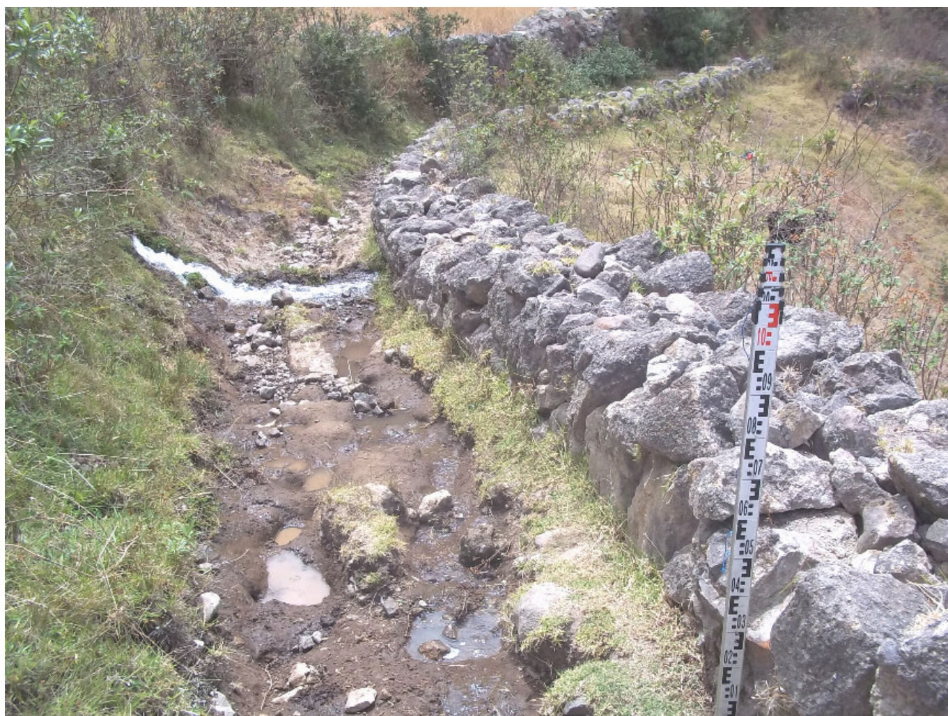
Figura 5. Estado del Qhapaq Ñan , tramo Sevilla-Nizag (2 + 000 km), con una de las muchas vertientes de agua que pasan por él.
