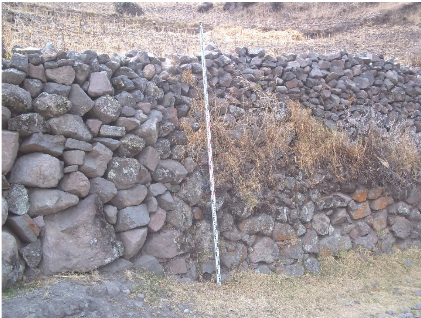
Figura 7. Estado del Qhapaq Ñan , tramo Sevilla-Nizag (2 + 700 km). Se pueden apreciar varias reconstrucciones modernas en el muro y la parte más antigua inferior.
