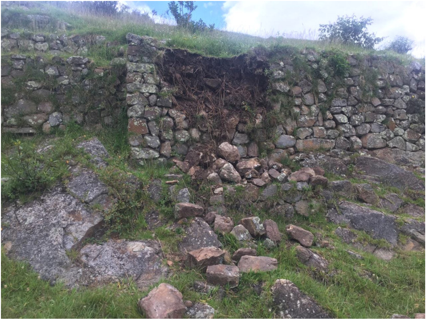
Figura 2. Muro colapsado en el sitio arqueológico Cojitambo.
